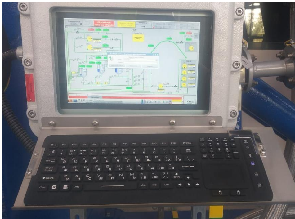
Рисунок 3.3 – Общий вид панели управления БНП.
