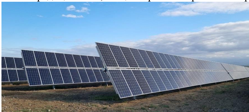
Рис. 6. Ачхой-Мартановская СЭС мощностью 9,2 МВт. Объем годовой выработки электроэнергии - 13 млн кВт·ч
