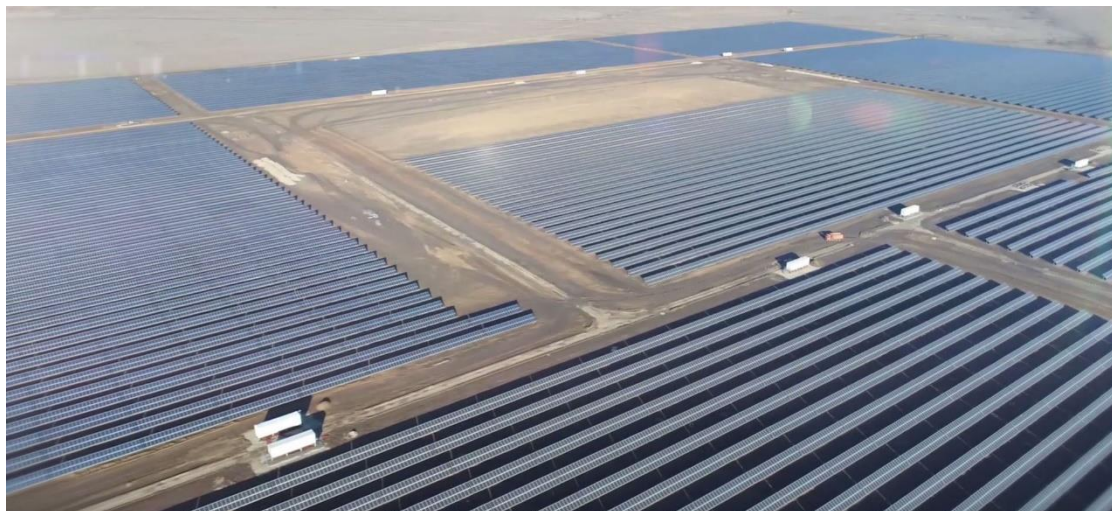
Рис. 3. Фунтовская СЭС мощностью 60 МВт с подключением к электросетям напряжением 110 кВ
