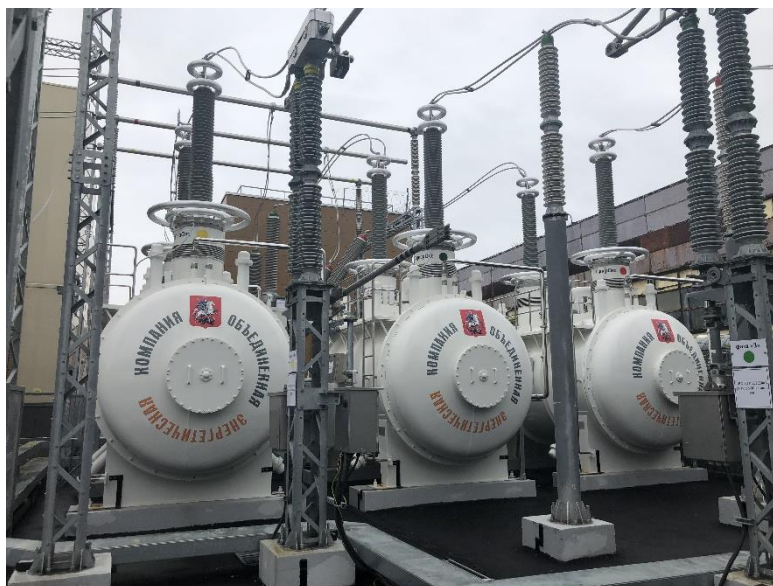
Рис. 4. ВТСП ТОУ 220 кВ, ПС Мневники в Москве.
