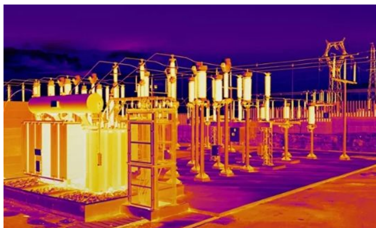
Рис. 2. Фото с тепловизионной камеры FLIR A850 ОРУ подстанции
