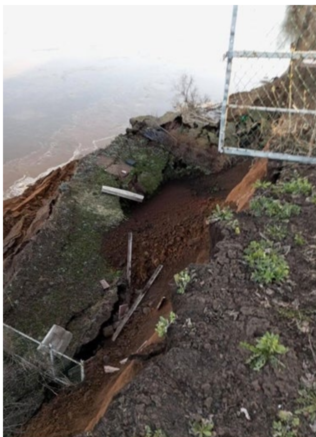
Рис. 2. Разрушение берега р. Белой в с. Охлебино 17.04.2025 г. [Фото очевидцев; До обрыва – метры..., 2025]
