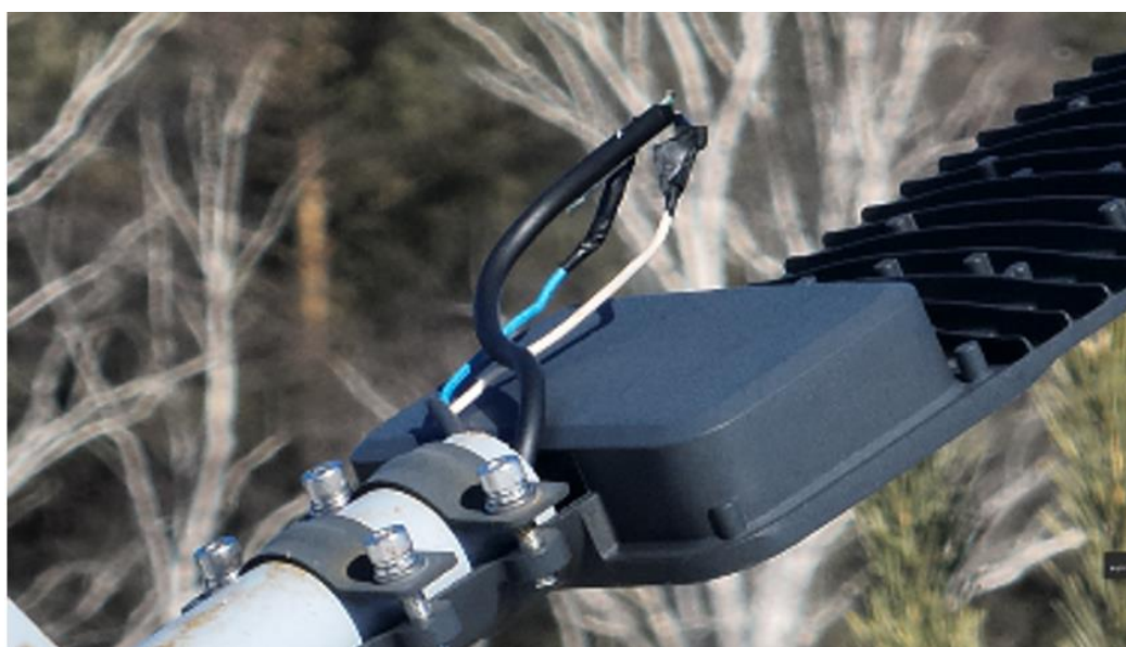
Рис. 3. обнаруженный дефект при подключении фонаря освещения дворовой территории МКД: нарушена изоляция провода.
