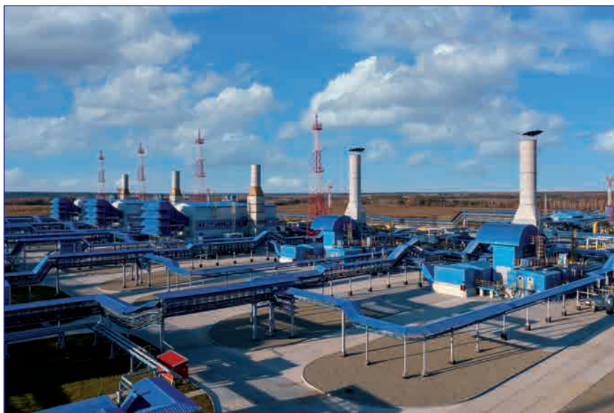
ГПА-16У на базе ГТУ-16П. КС «Зейская», ООО «Газпром трансгаз Томск»
